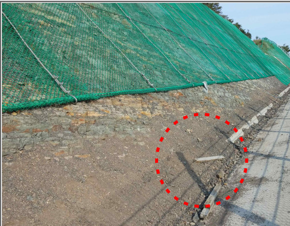
③ Sta.5+060~5+160부근(상주) 20m소단 배수로 파쇄암편 및 폐자재 방치
